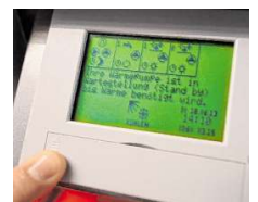
Das Kontrolldisplay einer Wärmepumpe, die sich durchaus rentiert. SYMBOLBILD: DPA
